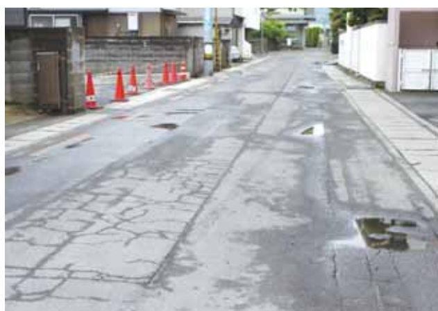
ひび割れた道路
