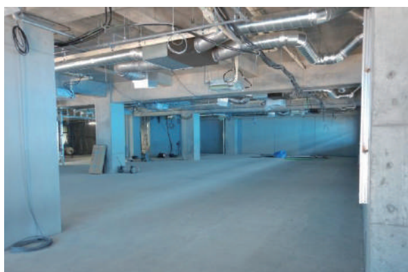
1階天井内の配線、配管等の様子(体育館棟)
