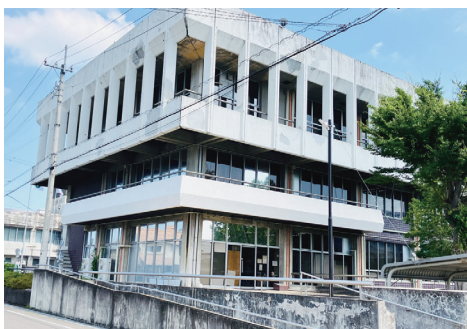
歴史を感じる重厚な造りだが、所々に剥離や割 れが目立つ。庁舎の未耐震問題にも注視してい きたい。
