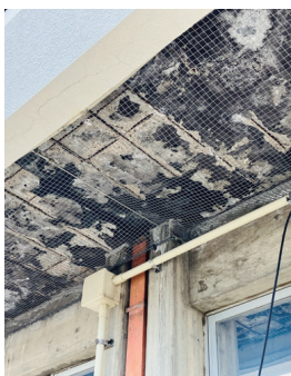
コンクリートが剥離し、 鉄筋がむき出しに。
