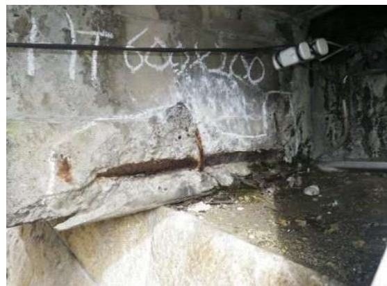
コンクリートの剥離
