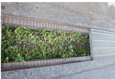
町道側溝内の堆積土砂に茂る雑草
